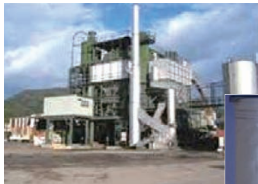
アスファルト合材再生プラント
