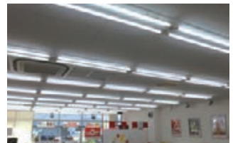
LED照明の導入
