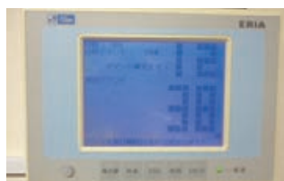
使用電力監視システム
