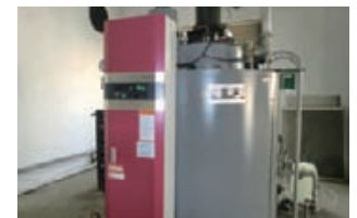
高効率重油ボイラに更新
