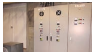
空調用冷却水ポンプモータインバータ制御盤
