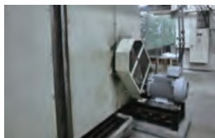
送風機にインバータを設置
