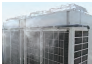
空調室外機への散水
